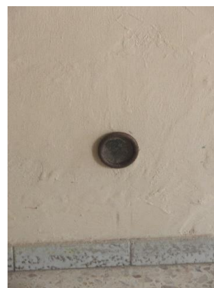
Ventilacion con tapaboca
